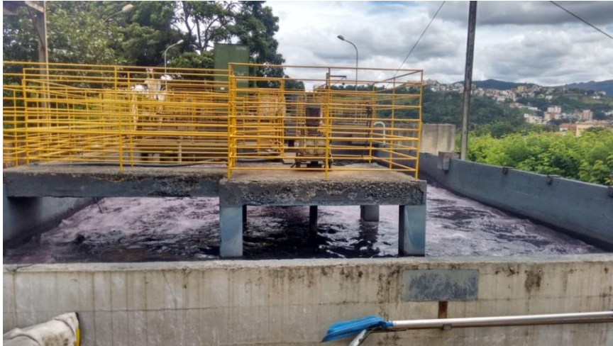
Figura 7. Tanque de aerção do sistema de lodos ativados da Cia Itabirito Industrial. Fonte: Foto tirada pelo autor.
